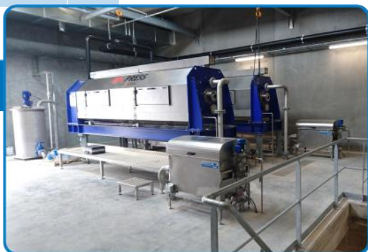
Slamafvanding med IEA skrupresse - Solrødgaard Renseanlæg, Hillerød
